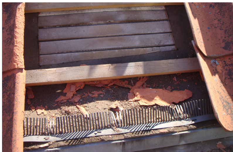
Destruktiv undersøgelse af tag viste store mængder afskalninger af forvitrede sten.
