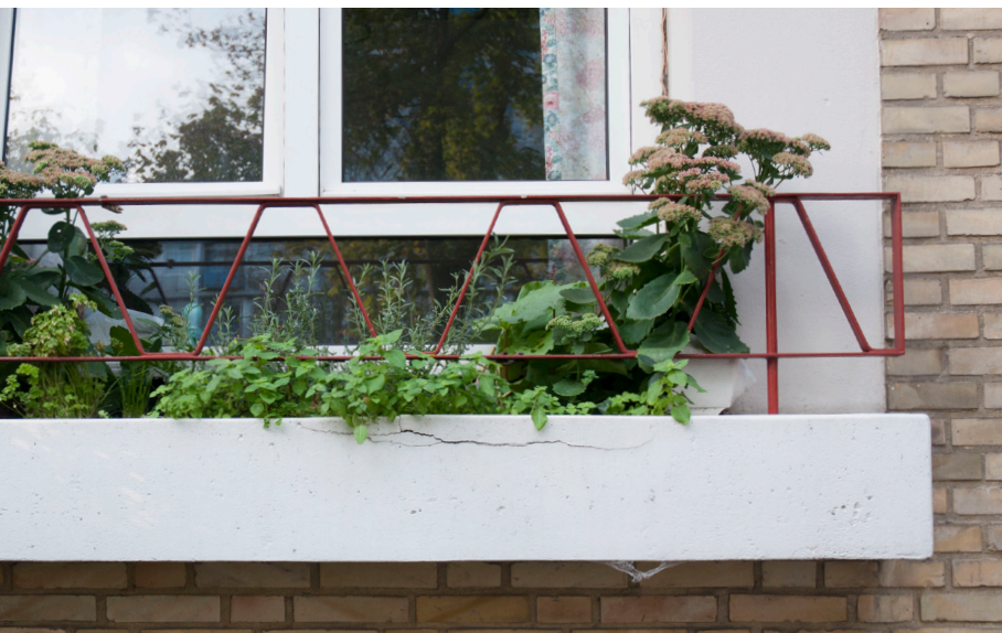
Tydeligt skadet beton på blomsterkumme
